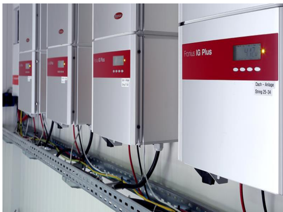
Fig. 36. Inversors. S'encarreguen de transformar el corrent continu en altern 92 .
